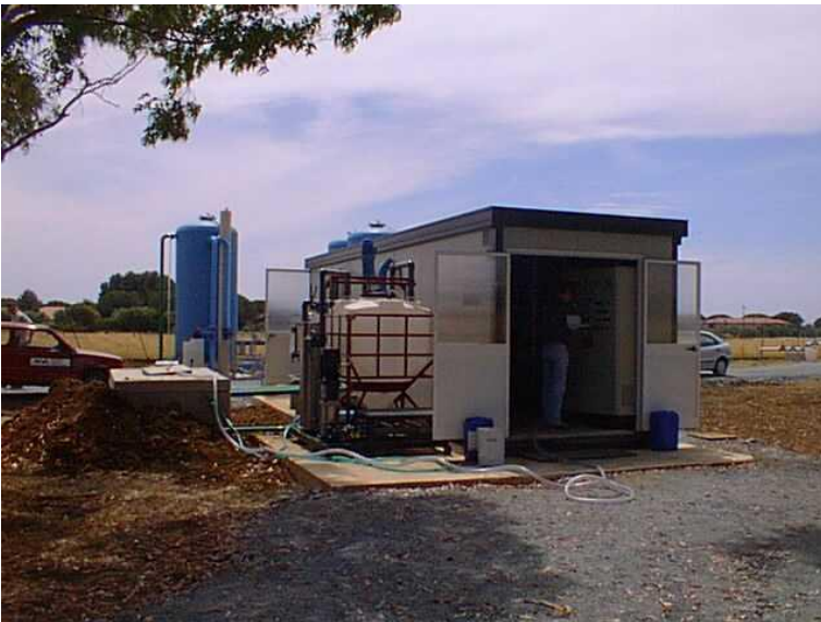
Impianto OR San Pietro in Palazzi con annesso sistema di lavaggio membrane esterno
