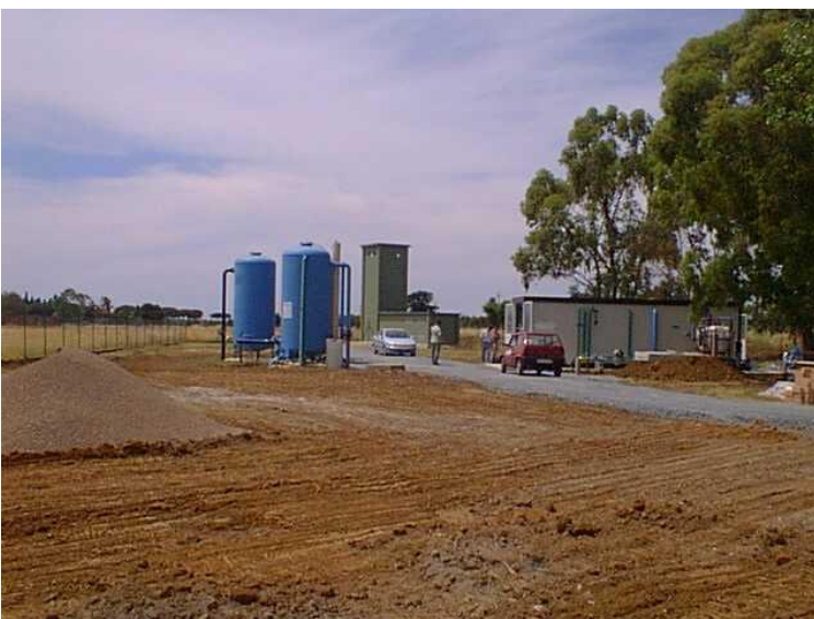
Impianto OR San Pietro in Palazzi e serbatoi di coacervo in uscita
